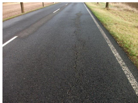
Längsrisse und Querrisse
