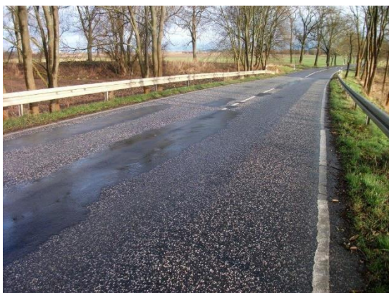
Längsrisse auf der ganzen Fahrbahnlänge
